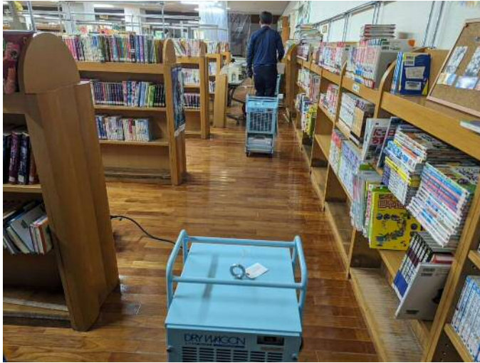
災害支援ふくおか広域ネットワーク DISASTER RELIEF NETWORK FUKUOKA
