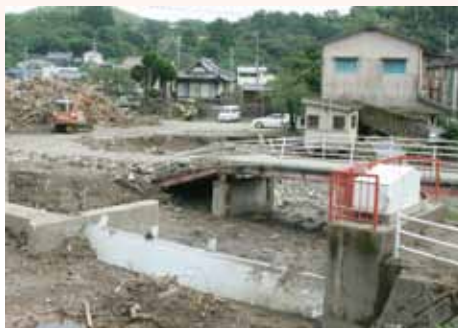
洪水により崩落した橋（八女市）
